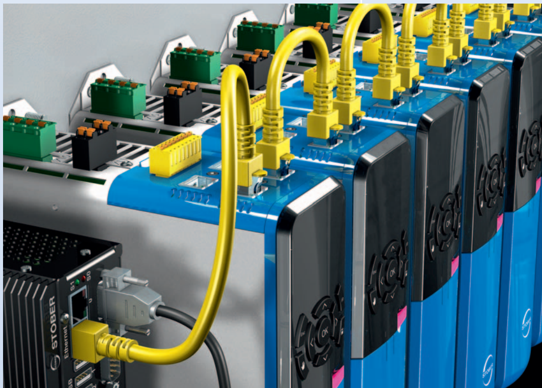
Antriebsregler im Multiachs-Betrieb, gesteuert vom STÖBER Motion Controller MC6 über EtherCAT®.
